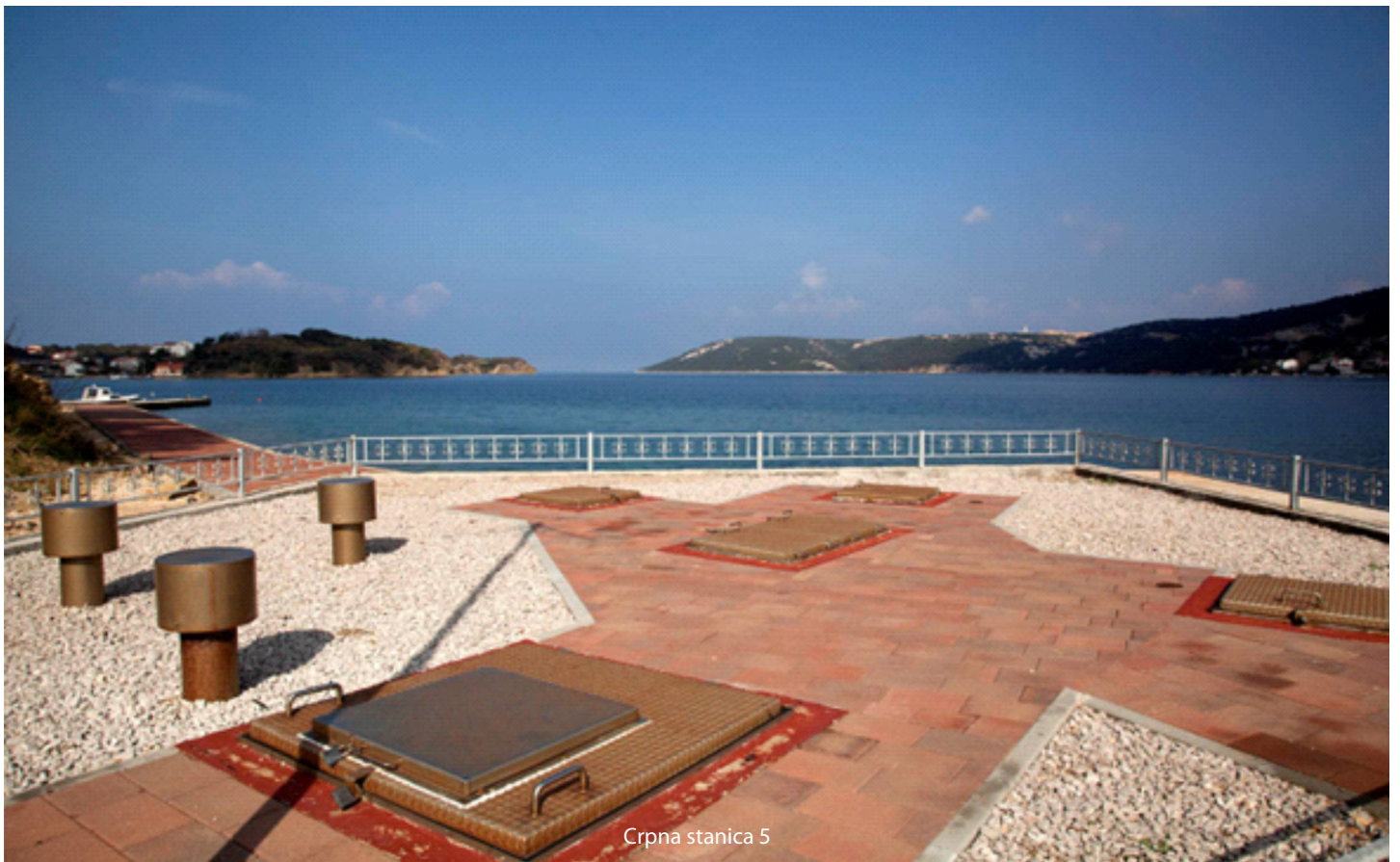
Crpna stanica 30 (Janići)
